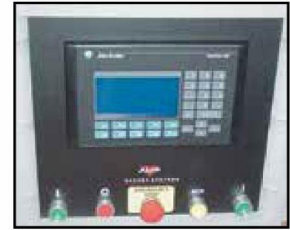
オペレーターインターフェースパネル
